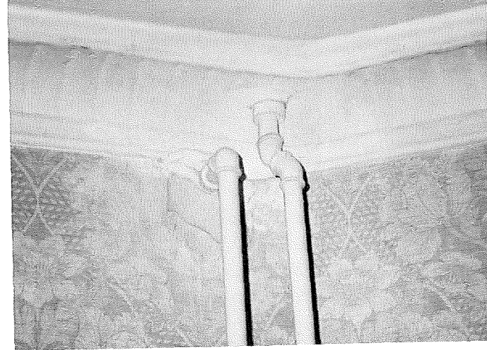
Figur 17. Etagegennemføring for stigestreng til varmeanlægget, hvor fremløbet er ført igennem etageadskillelsen med en lille forskydning, medens returen er ført ind i væggen, for at få røret op det rigtige sted på den overliggende etage.
